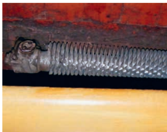
Topné těleso parního topení ve voze
